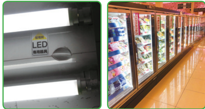
LED照明への切り替え
